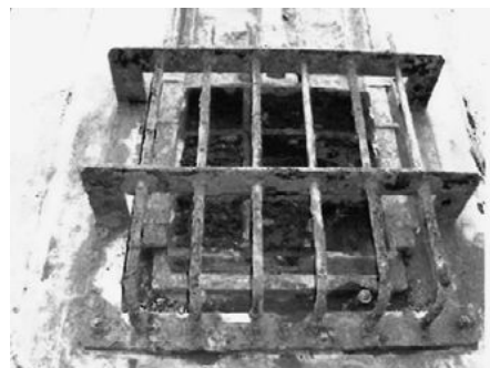
スライドゲート扉体、 シリンダ部腐食状況(土砂吐ゲート)
