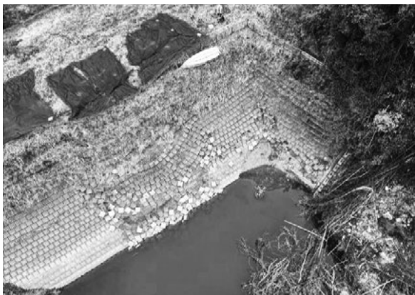
ため池の被災状況（輪島市）
