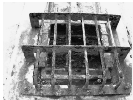
スライドゲート扉体、シリンダ部腐食状況(土砂吐ゲート)
